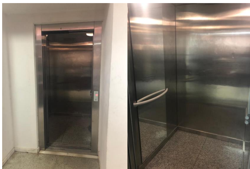
Figura 4 - ELEVADOR DO BLOCO 5
